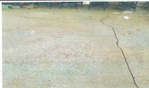
Foto 2: Fotografía del piso de las aulas que necesita ser sustituido.
