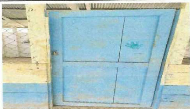
Foto 3: Fotografía de las puertas de las aulas que necesitan ser sustituidas por metal
