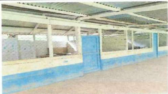
Foto1: Fotografía que evidencia la necesidad de rehabilitar el aula para construir tres hiladas de block así como la renovación de pintura.
