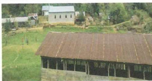
Foto 4: Fotografía del techo de laminas de la cocina que urge cambiarlas.
